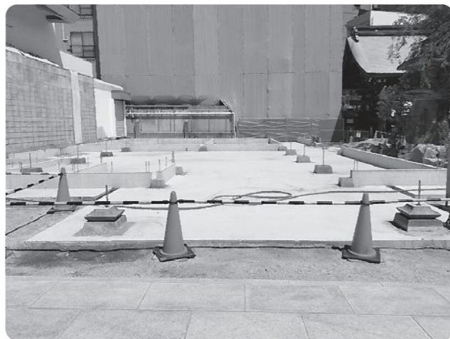
引取り加工、設置状況 ※解体時に出てきた既存礎石を台形に切り研磨を施し再利用しております。
